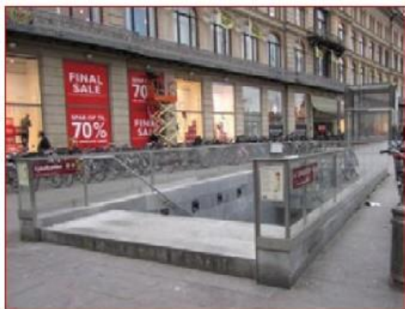
Surélévation des entrées du métro de Copenhague (European Environment Agency, 2014)
