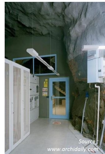
Pionien Data Center de Stockholm
